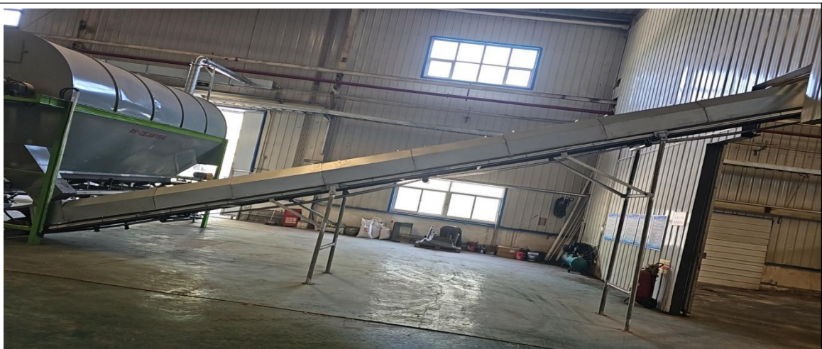
皮带输送机封闭
